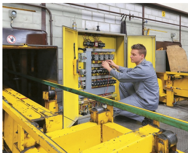
2 Dépannage dans l'armoire de commande d'une machine.
