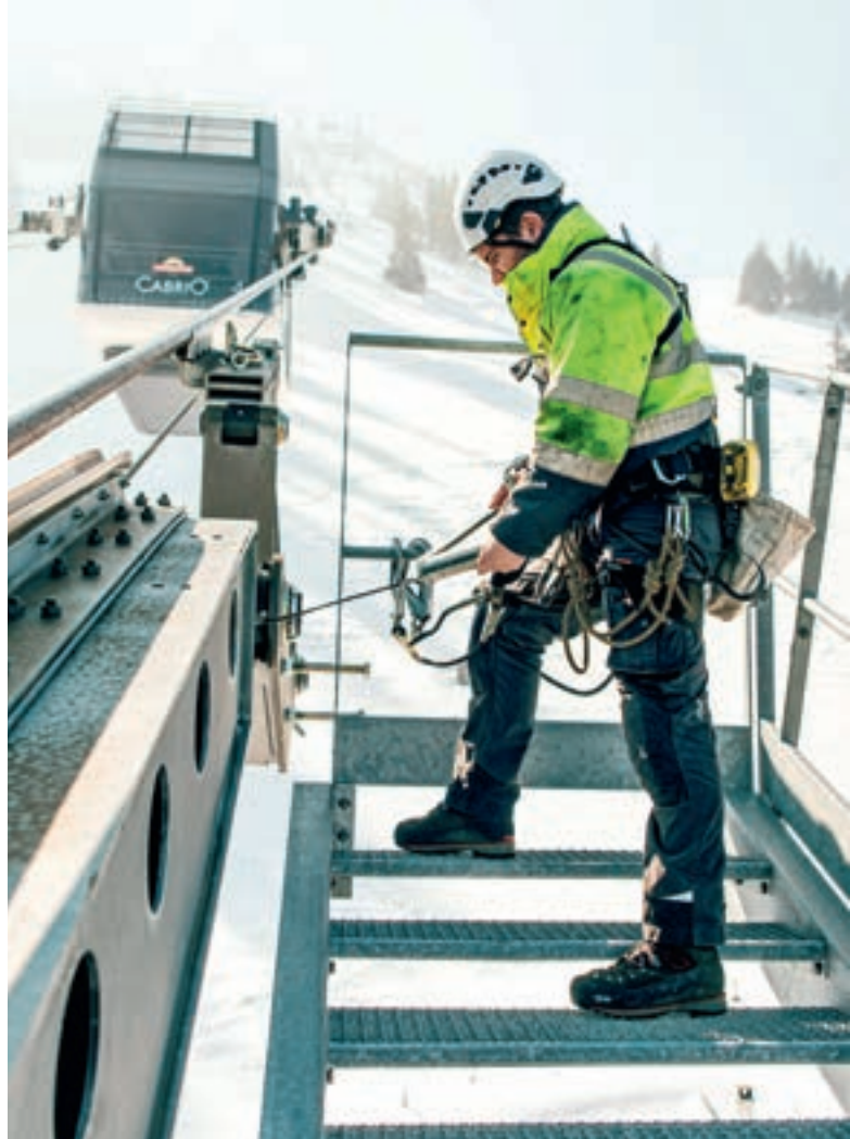
Beim Schmieren der Seilsättel ist die Gefahr einer Kollision mit der Seilbahn zu beachten.
