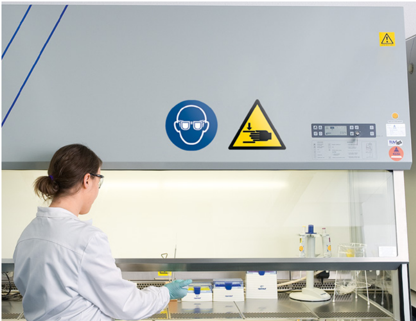
Figura 20 Segnale di obbligo e di avvertimento su una cabina di sicurezza microbiologica
