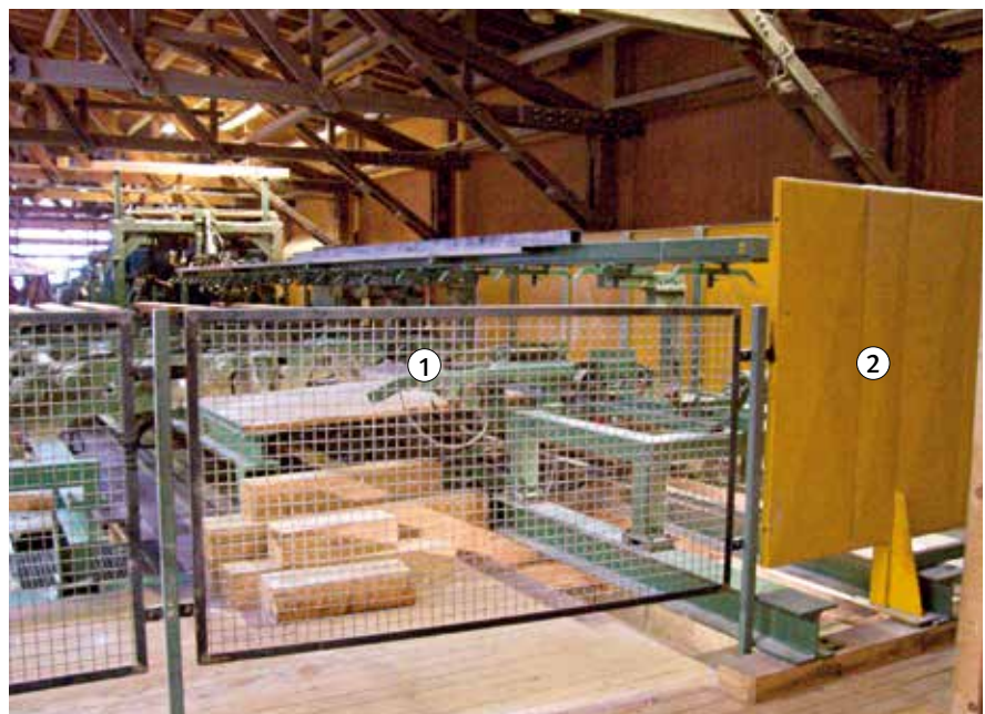
Bild 14: Zuführbereich zur Nachschnittsäge mit Gegen- und Gleichlaufbearbeitung der Sägeblätter
