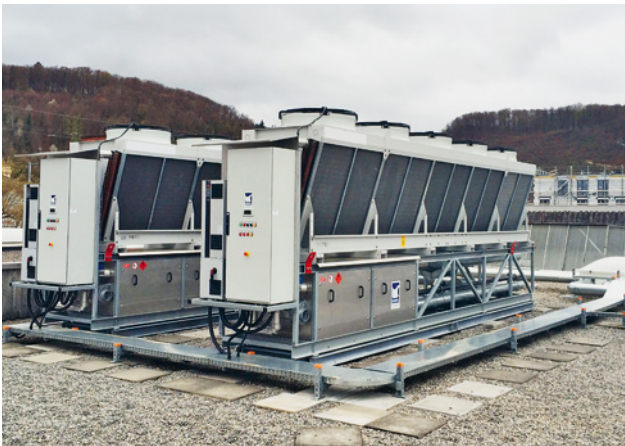
Kälteanlage im Freien.
