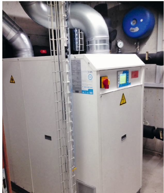
Kälteanlage in belüftetem Gehäuse.
