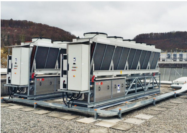
Kälteanlage im Freien.
