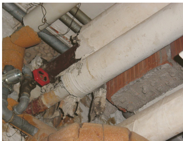
1 Malta isolante contenente amianto
