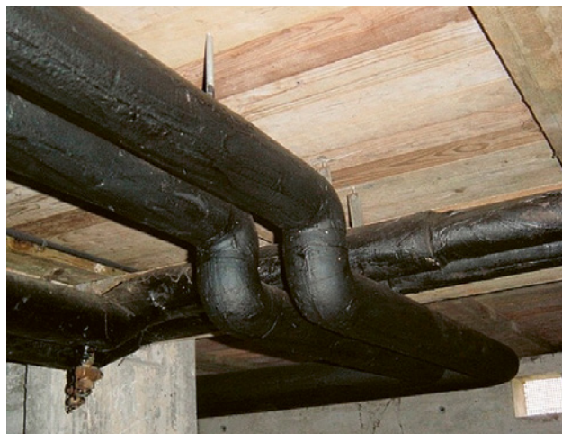
2 Guaina bituminosa contenente amianto
