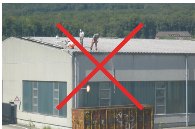
1 et 2 Absence de mesures de protection appropriées lors de travaux sur un toit en fibrociment et à proximité de plaques transparentes.
