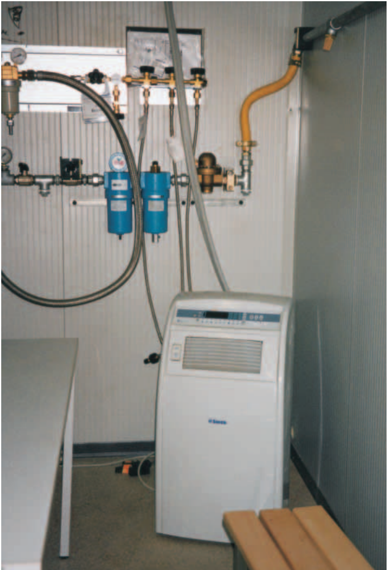
Abbildung 5 Mobiles Klimagerät im Rettungscontainer einer Tunnelbohrmaschine zur Erzeugung von Temperaturen unter 25° C.
