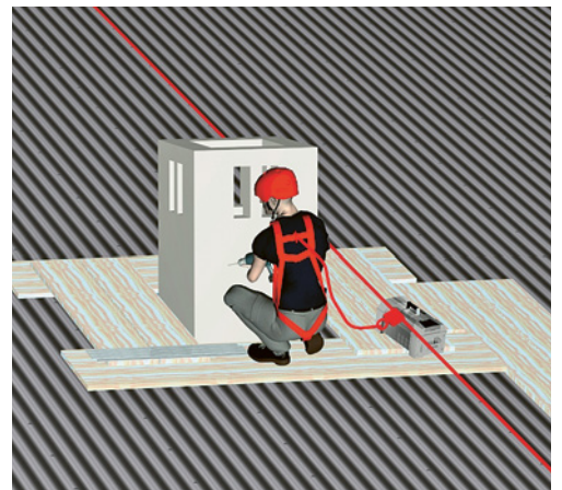
4 Arbeit auf einem nicht oder beschränkt durchbruchstauglichen Dach mit Seilsicherung und sicheren Arbeitsflächen.
