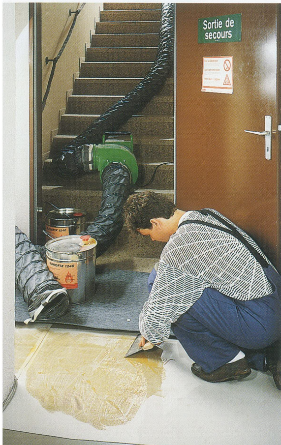
Bild 1: Auftragen eines lösemittelhaltigen Klebstoffes in einem Kellergeschoß vor dem Verlegen des Bodenbelages. Absaugschlauch und explosionsgeschützter Ventilator.
