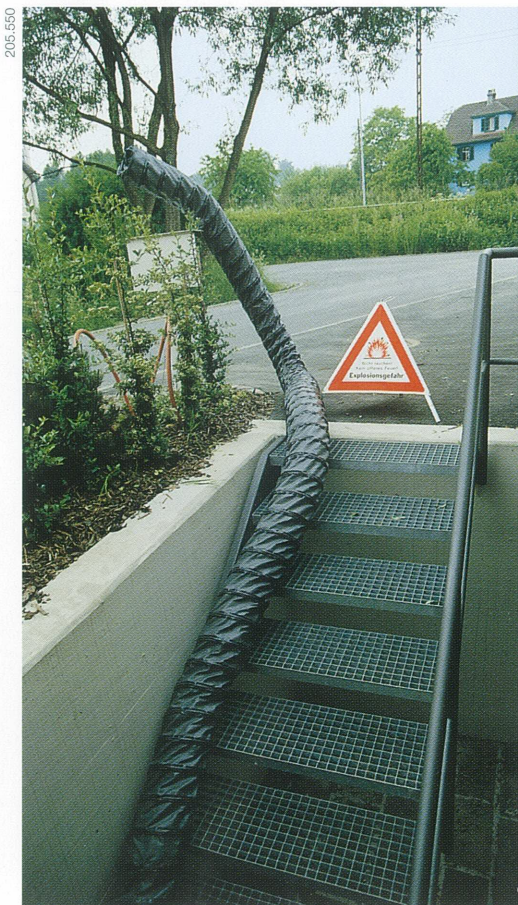
Bild 4: Gefahrenzone. Warndreieck und Absperrung, hier beim Austreten der Lösemitteldämpfe ins Freie. Auf die gleiche Weise muss der Arbeitsbereich abgesperrt und signalisiert werden.
