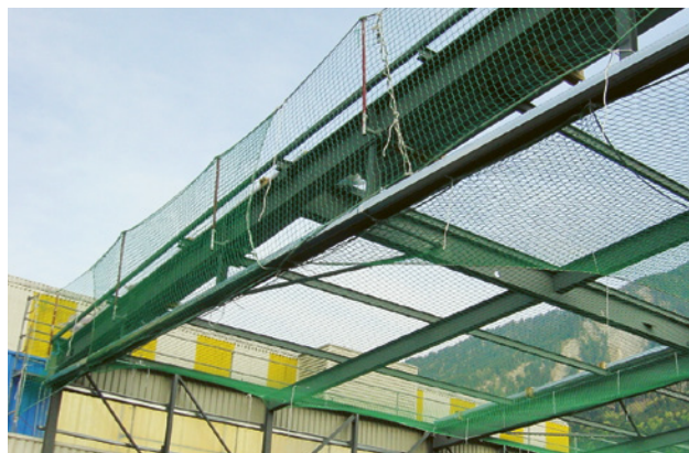
4 Pour cette construction industrielle, le filet du garde-corps périphérique permet de sécuriser le bord du toit.
