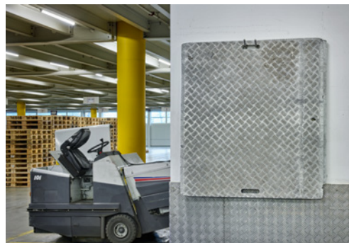
5 An der Wand befestigte Überladebrücke
