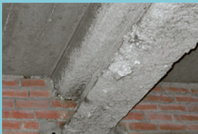
Isolation en amiante floqué
