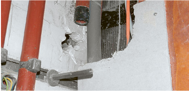
Panneau coupe-feu dans un puits d'accès
