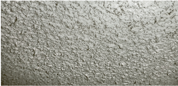
Crépi acoustique amianté
