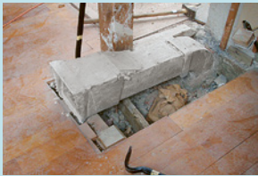
Canal de ventilation en fibrociment
