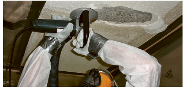
Enlèvement uniquement par des entreprises en désamiantage reconnues
