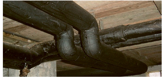
Revêtement bitumineux amianté
