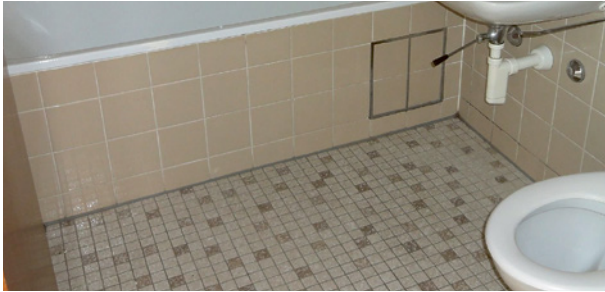
Carrelages et faïences avec colle amiantée
