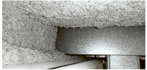
Revêtement d'amiante floqué au plafond sur une poutre métallique
