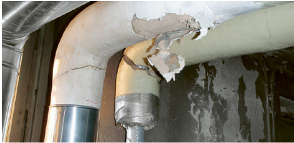
Tuyau avec mortier amianté
