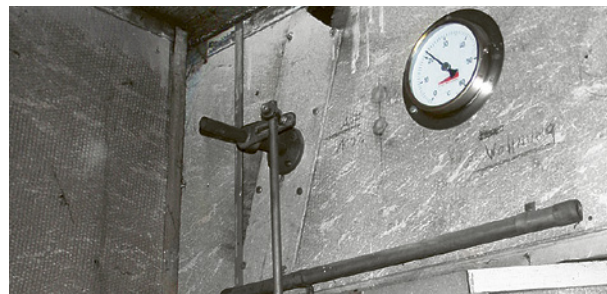
Conduit d'aération avec plaques en fibrociment
