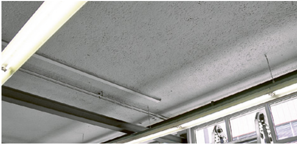
Revêtement d'amiante floqué au plafond
