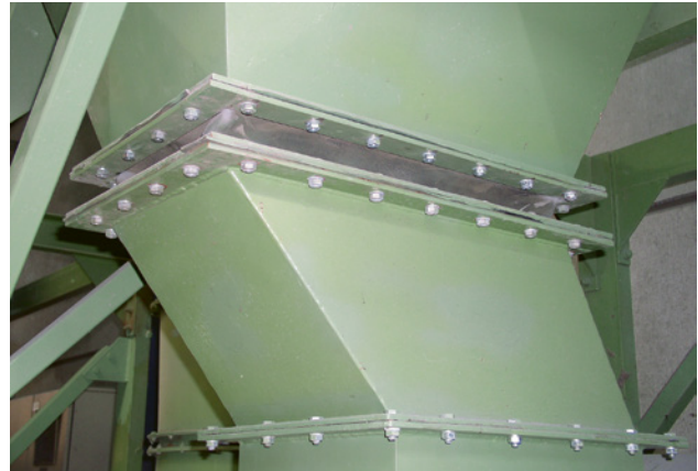
69 Elemento di compensazione in plastica posizionato nella condotta di scarico dell'aria di un impianto di processo
