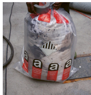
6 Sac en plastique avec marquage «Amiante».
