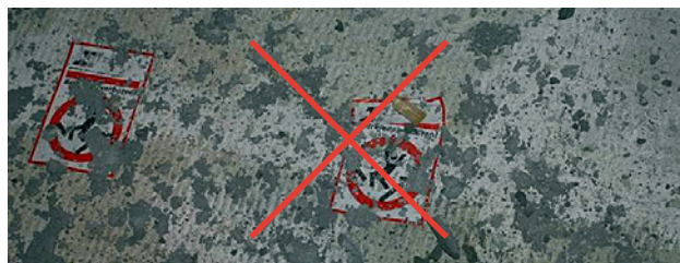
5 Hinweiskleber auf den Brandabschottungen genügen nicht. Die Brandabschottung muss durchbruchssicher sein.
