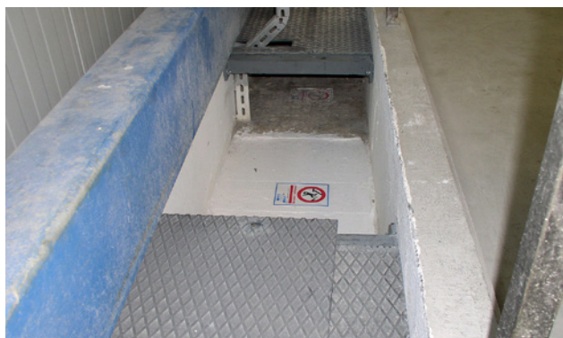
4 Durchbruchssichere Brandabschottung mit begehbarem Riffelblech
