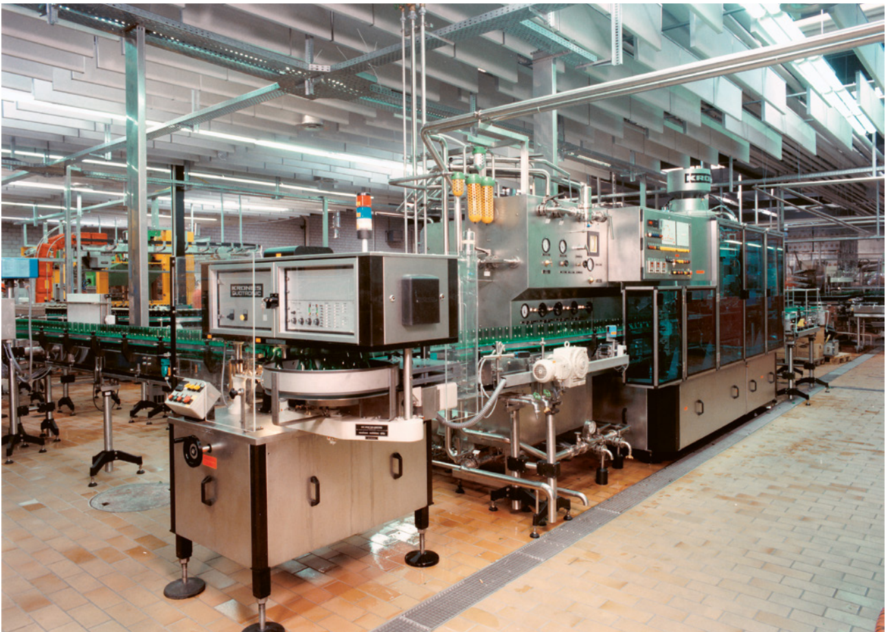
16 Baffles en panneaux acoustiques en laine minérale dans l'industrie des boissons (installation de remplissage).
