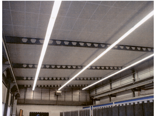
15 Panneaux acoustiques doublés de laine minérale dans une ferblanterie.
