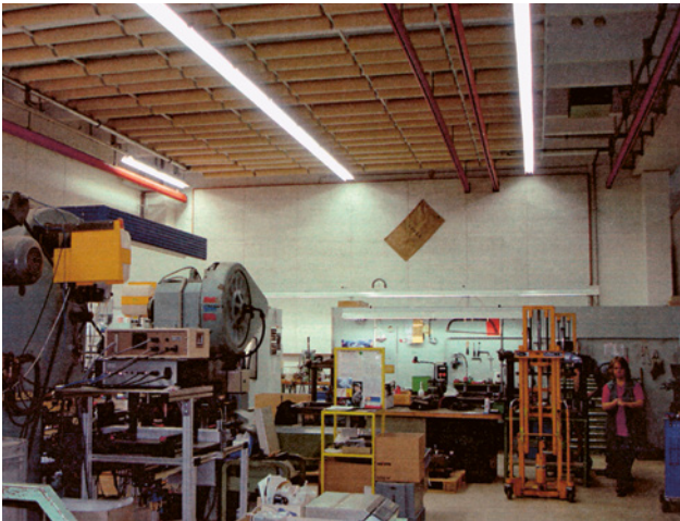
17 Correcteurs compacts absorbeurs dans un atelier de découpage.
