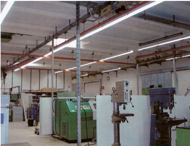
14 Panneaux acoustiques en fibres minérales dans une entreprise de mécanique.
