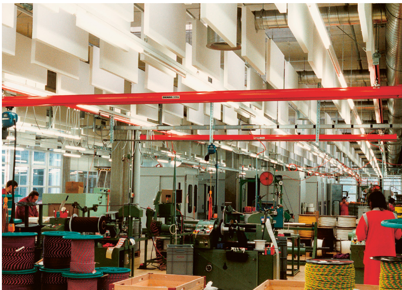
33 Usine avec des baffles au plafond.
