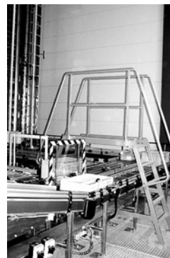
6 Passaggio sopraelevato a un trasportatore a rulli
