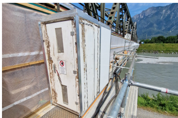
2 Sas de décontamination
