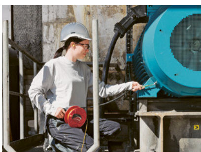
1 Contrôle du conducteur de protection.
