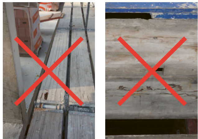
Fig. 2 et 3 Les platelages entaillés ou endommagés doivent être remplacés.
