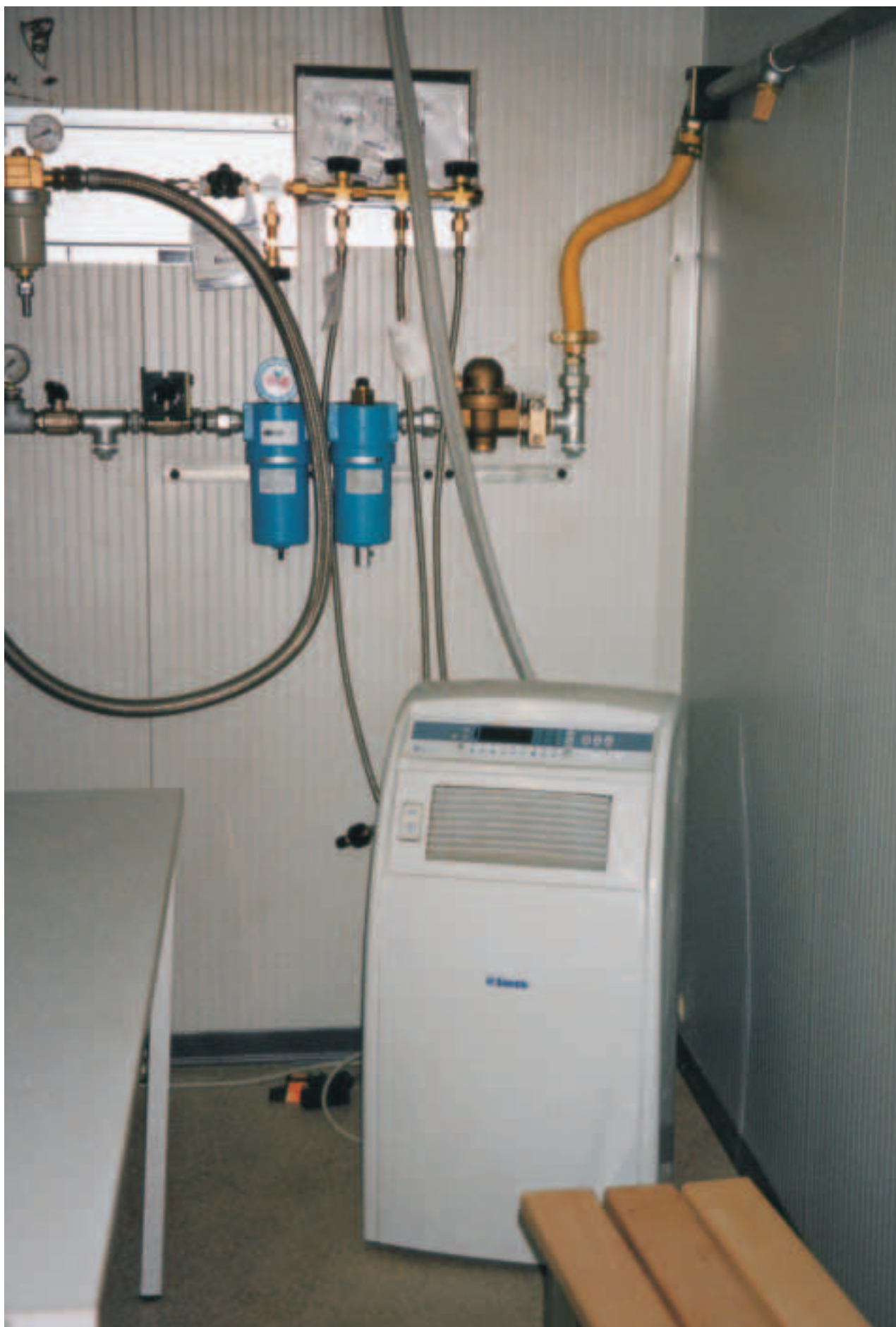
Figure 5 Appareil de climatisation mobile se trouvant dans la cellule de secours d'un tunnelier et permettant d'obtenir une température inférieure à 25° C.
