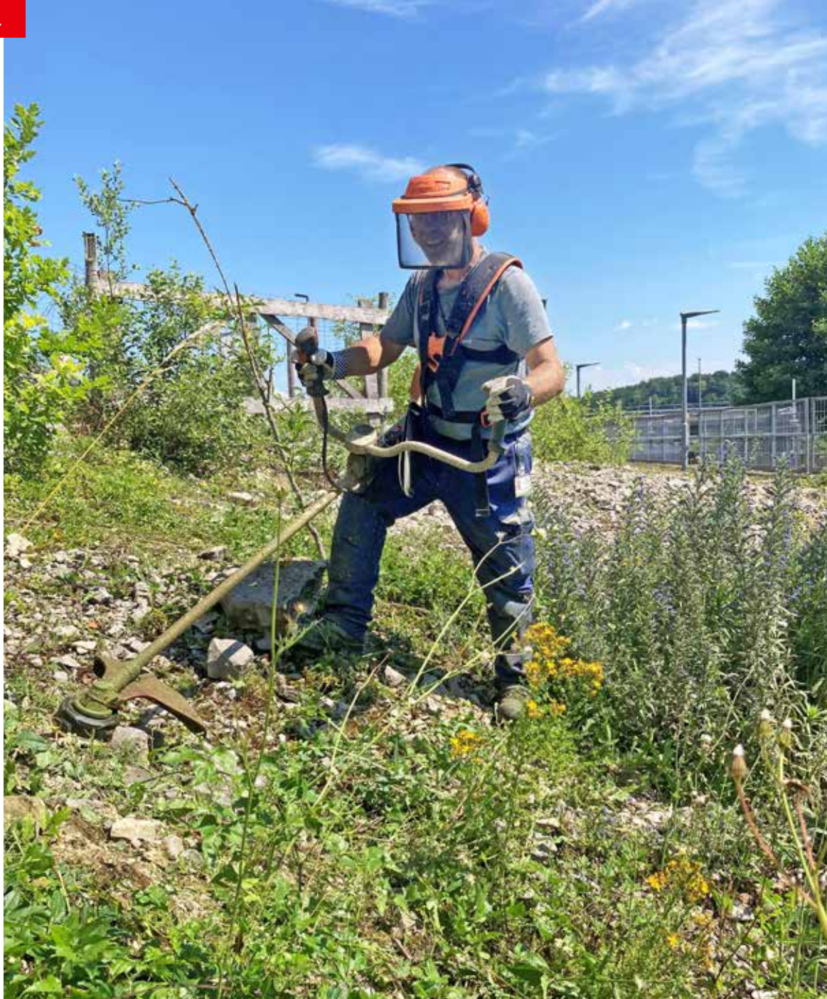
Le risque de chutes et faux pas est accru lorsque l'on travaille sur un terrain accidenté.
