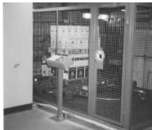
Figura 6: impianto con carrello e tavola rotante in ambiente chiuso con porta protetta.
