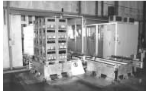
Figura 1: per poter verificare la presenza e lo stato dei dispositivi di sicurezza è necessario avere a disposizione un elenco completo degli stessi.
