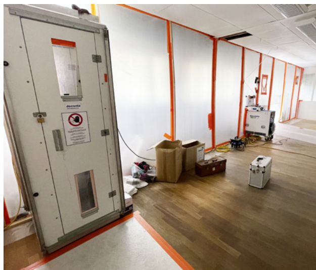
1 Transformation: extracteur d'air et sas à l'entrée de la zone
