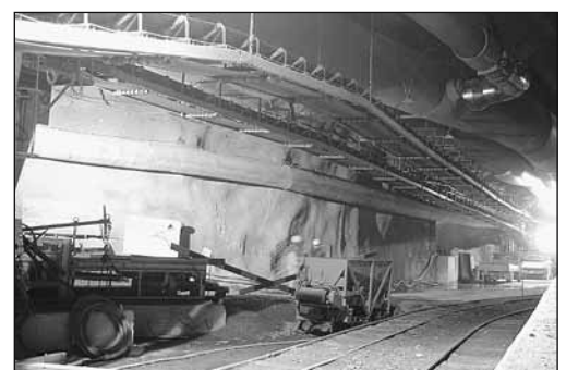
Bild 4: Tunnelband und Versorgungsleitungen ausserhalb des Verkehrsbereichs.
