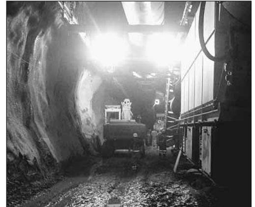
Bild 1: Gefährdung von Personen durch Transportmittel infolge enger Platzverhältnisse beim Sprengvortrieb.
