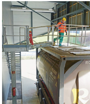
Regel 5 Gegen Absturz sichern.
