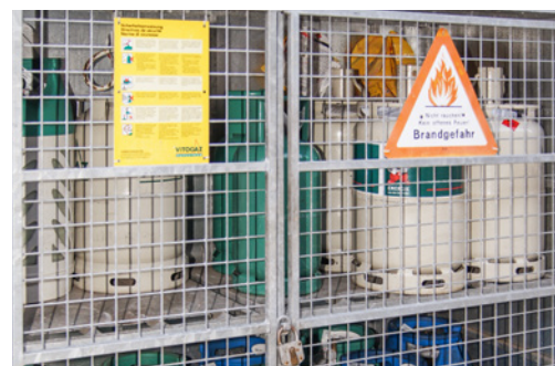
Bild 8: Korrekt gelagerte Gasflaschen
