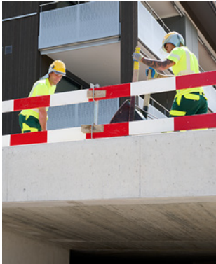
Regel 4 Absturzkanten sichern – ab einer Absturzhöhe von 2 m
