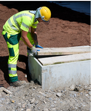
Regel 7 Boden- und Dachöffnungen sichern
