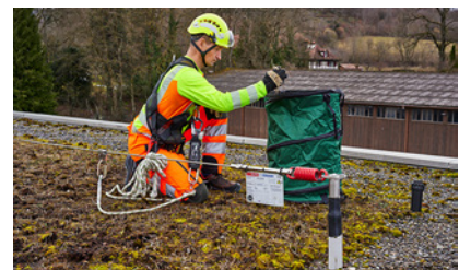
3 Absturzsicherung mit Auffangsystem
