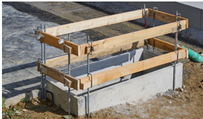
1 Lichtschacht mit Seitenschutz gesichert
