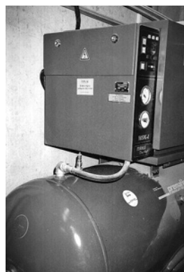
2 Les équipements sont facilement accessibles.
