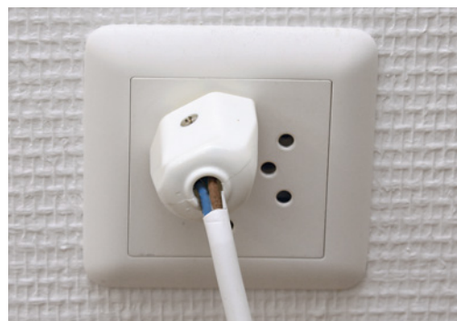
Fig. 22: remplacer immédiatement les câbles électriques défectueux.
