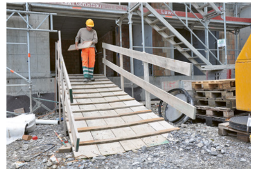
7 Sicherer Baustellenzugang mit Seitenschutz und Querstreben. Baustellenzugänge müssen mindestens 1 m breit sein.
