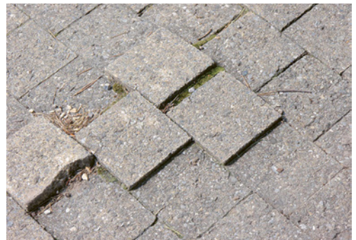
3 Solche Bodenunebenheiten auf dem Firmenareal sind heimtückische Stolperfallen.
