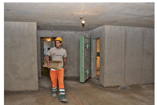
8 In Rohbauten muss eine Beleuchtung vorhanden sein.
