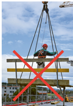
2 Auch mit Seilsicherung ist der Personentransport auf Betonierbühnen unzulässig.
