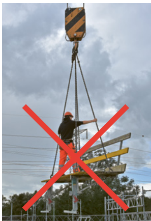
1 Es ist verboten, Personen auf Betonierbühnen zu transportieren.
