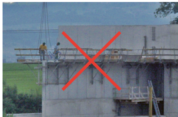
3 Nie ohne Absturzsicherung arbeiten.
