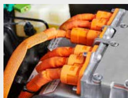
Cavi arancioni per identificare i sistemi ad alta tensione
