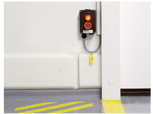
5 Alarmschalter mit Beleuchtung
