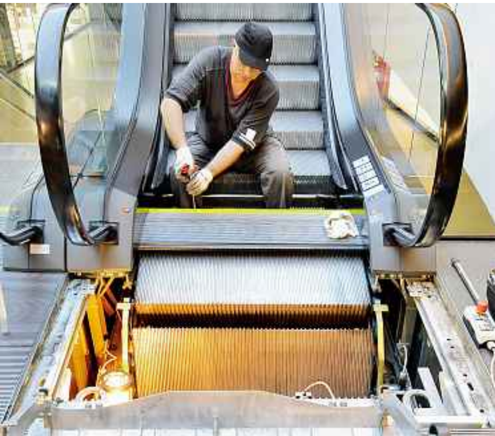
Rolltreppe vor unerwartetem Anlaufen sichern, Bereich absperren sowie Schutzhandschuhe und Schutzschuhe tragen.
