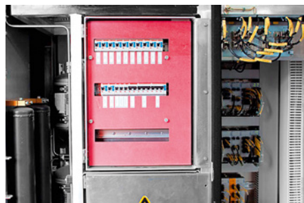
15 Un cache isolant évite le contact direct lorsque la porte de l'armoire est ouverte.
