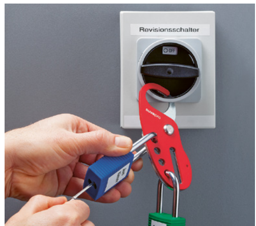
3 Mit dem Revisionsschalter kann die Anlage vor Instandhaltungsarbeiten sicher abgestellt werden.
