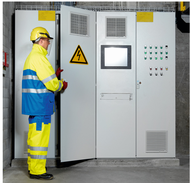
3 Öffnen einer Schaltschranktür mit der dafür notwendigen Persönlichen Schutzausrüstung (PSA)
