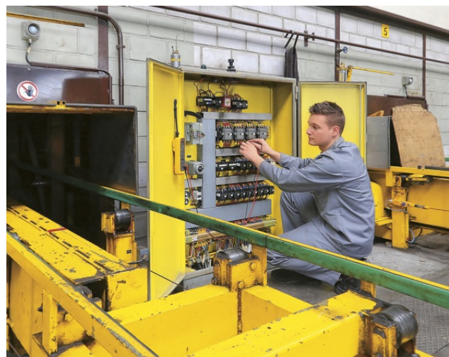
2 Störungssuche am Schaltschrank einer Maschine nach dem Hauptschalter
