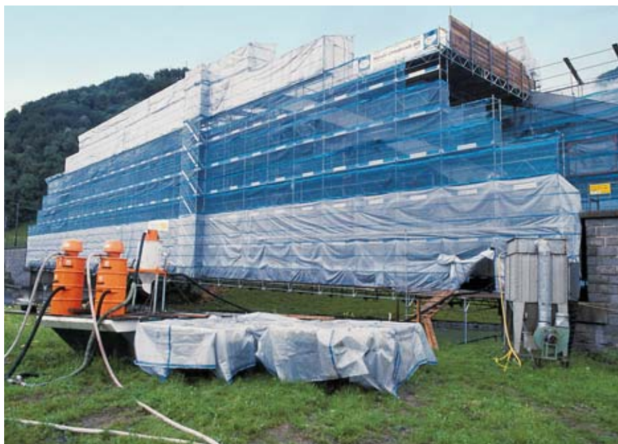
Installation de protection contre la poussière montée sur un pont métallique. En bas, on aperçoit l'installation d'aspiration et de dépoussiérage.
