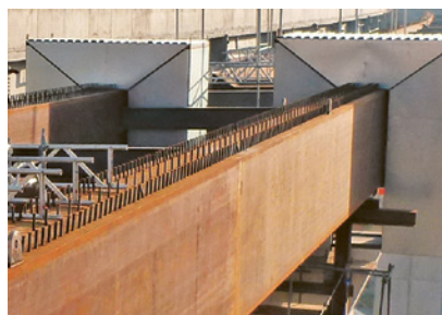
2 Struttura a involucro per saldature. Con qualità per la qualità: accessi sicuri, luoghi di lavoro sicuri.
