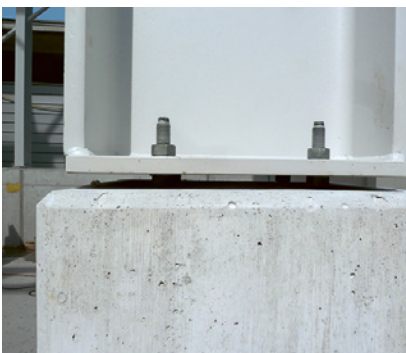
1 Piastra di base correttamente messa in sicurezza mediante 4 ancoraggi
