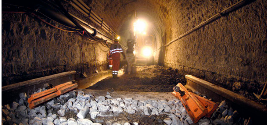
Hohe Luftkonzentrationen von Stickoxiden sind beispielsweise bei der Sanierung von engen, alten Eisenbahntunnels zu erwarten. (Quelle: Emch und Berger)
