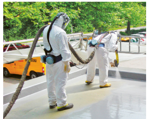
6 Für jede Arbeit ist die jeweils notwendige Schutzausrüstung festzulegen und einzusetzen.
