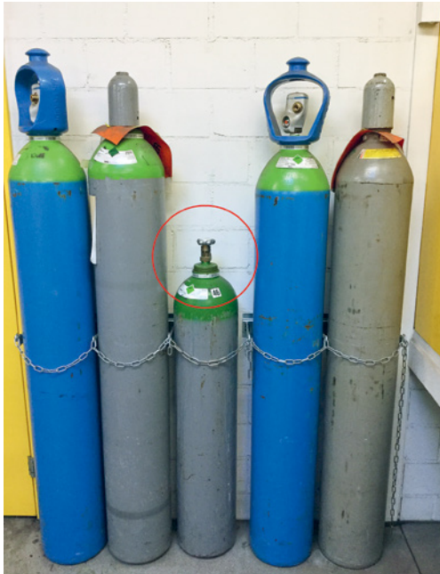
Bild 9 Mit Ketten gesicherte Gasflaschen. Bei der Flasche in der Mitte fehlt die Schutzkappe.
