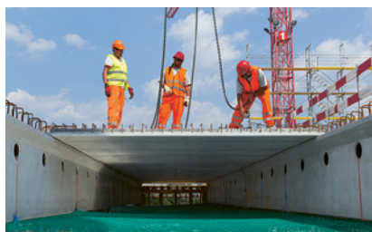
1 Recourir dans un premier temps aux mesures de protection collective (par ex. monter des filets de sécurité).
