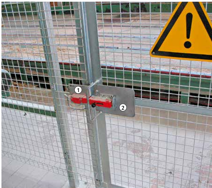
Bild 42: Elektrisch verriegelte Zugangstür
