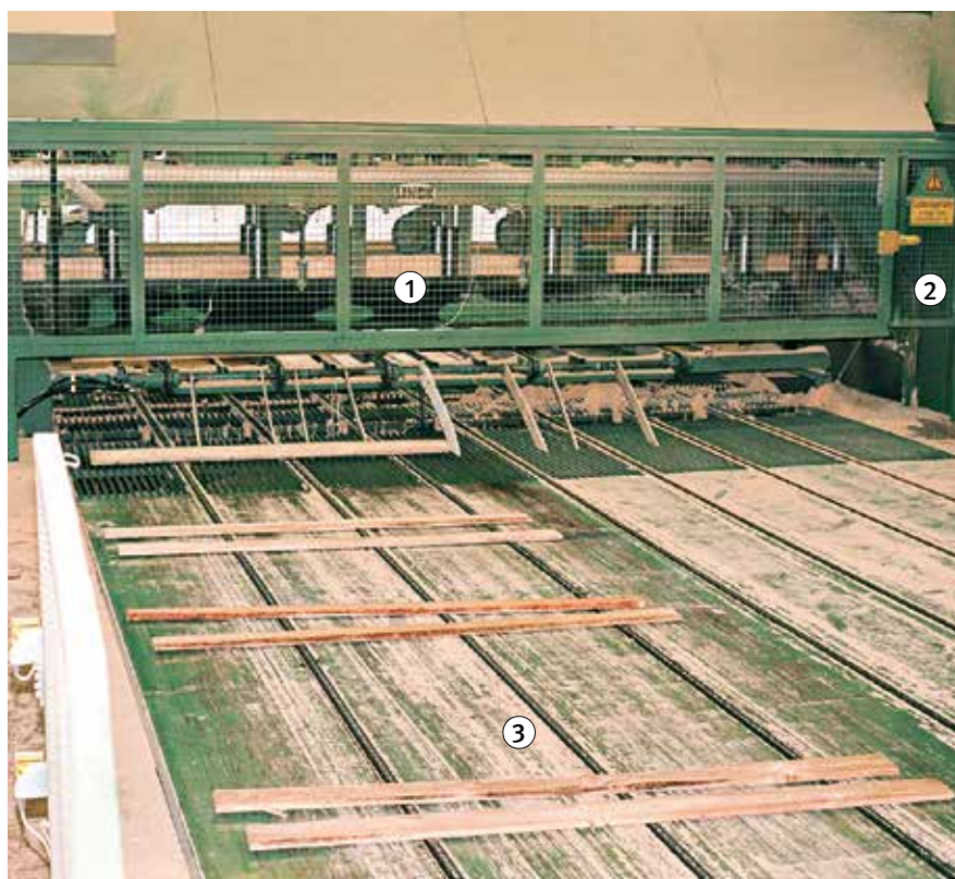
Bild 36: Ausführungsbeispiel Stetigförderer für Seitenwarenabtransport, um den Zugang zum Gefahrenbereich der Mehrblattkreissäge zu verhindern
