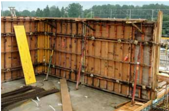
01 // Sbagliato: da questo ponteggio a mensole sono caduti i due operai finendo sul pavimento in cemento. Mancava anche la protezione laterale. // Foto: Suva
