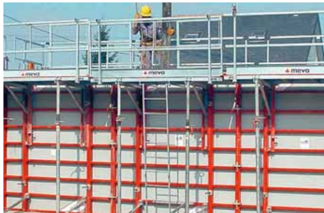
02 // Giusto: così si presenta un ponteggio montato correttamente con una protezione laterale a tre elementi. // Foto: zvg
