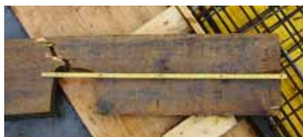
03 // La tavola dell'impalcato spaccata (larghezza 28 cm) che ha provocato l'infortunio. // Foto: Suva
