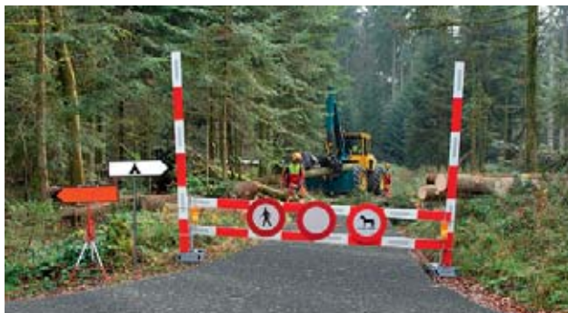
2 Barrage de route forestière composé de lattes rouges et blanches ainsi que de signaux pour tous les usagers
