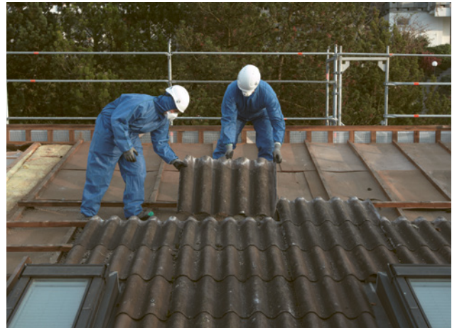
3 Per evitare pericoli per la salute, lo smontaggio deve avvenire senza distruzione e con i giusti dispositivi di protezione.
